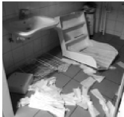
WC-Anlage Haus des Gastes
